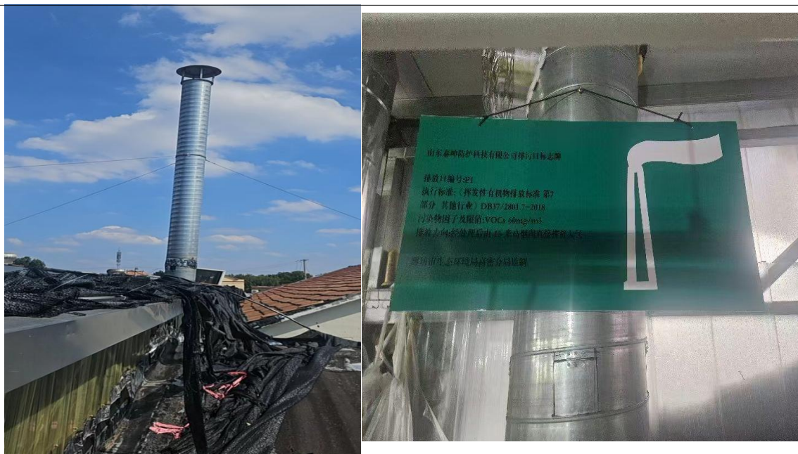
排气筒、采样平台及标识
